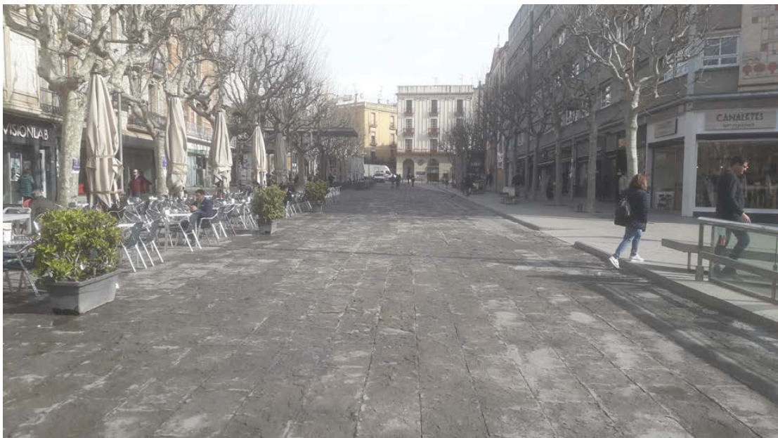
Vista de la Plaça Santa Anna, des del Camí Ral, on s'observa el paviment de pedra de Sant Vicenç deteriorat a substituir a la part central. La filera de plàtans que delimiten aquest espai i el grao existent al canvi de paviment.
