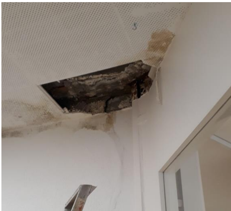
Goteres cantonada façana
