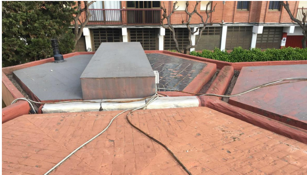
Passos d'instal·lacions per interfons a la coberta i diversitat de reparacions
