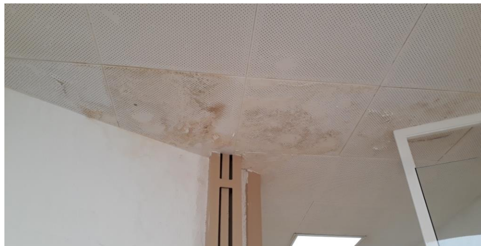
Gotera que situada a la junta de mòduls.
