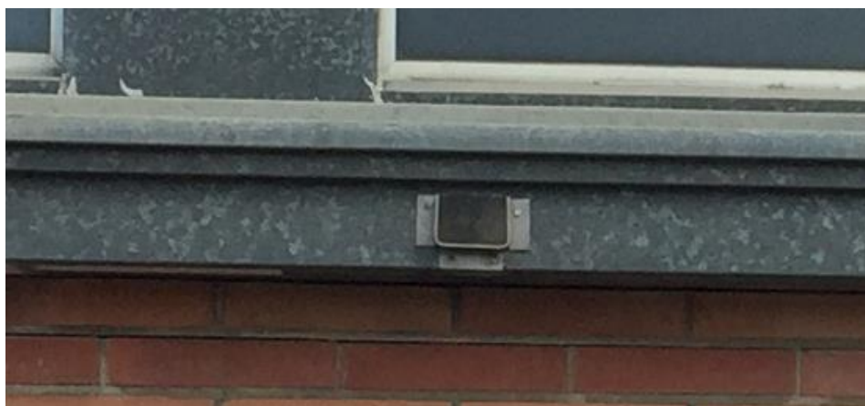
Sobreeixidors en canals vistos
