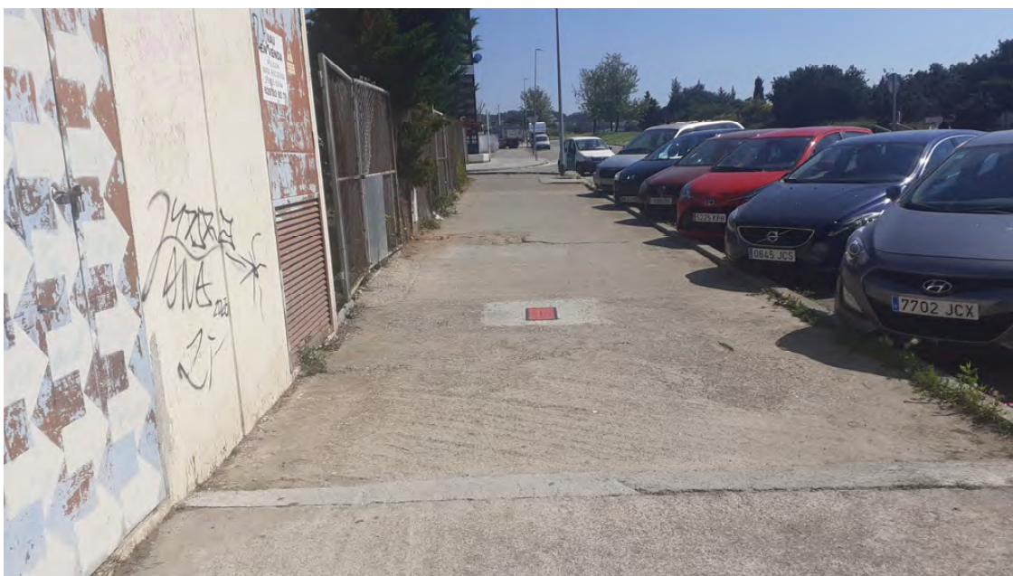
Vista de trams de vorera de formigó a reparar i/o completar al carrer Vapor Gordils
