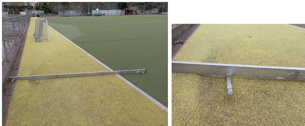
Figura 1. Imágenes del defecto de planimetría encontrado.
